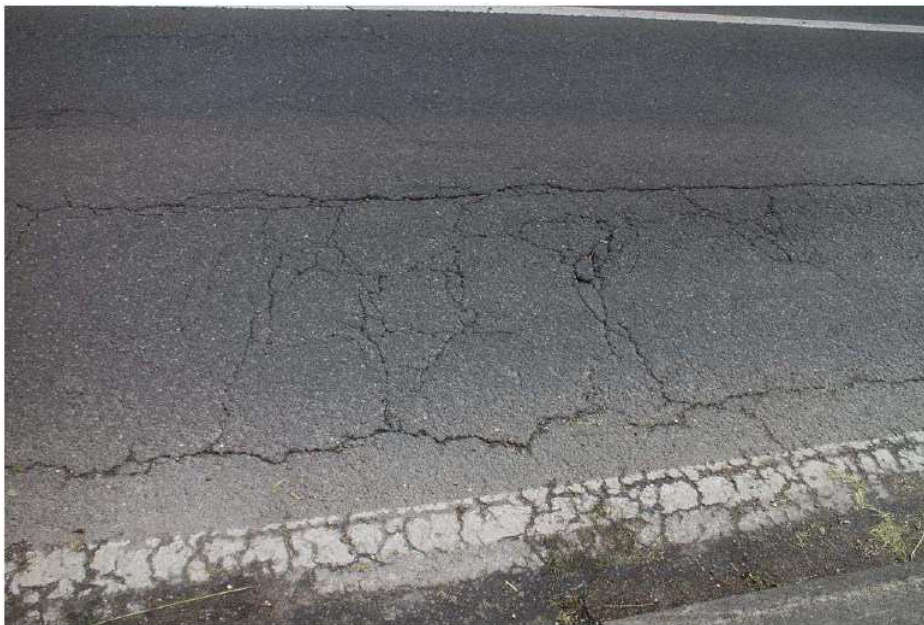
Figure 5 : état de la chaussée
