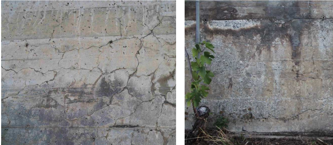
Fig. 15 : dégradations des murs en béton (RAG)
