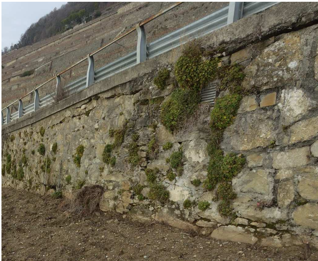
Fig. 16 : dégradations des murs en maçonnerie
