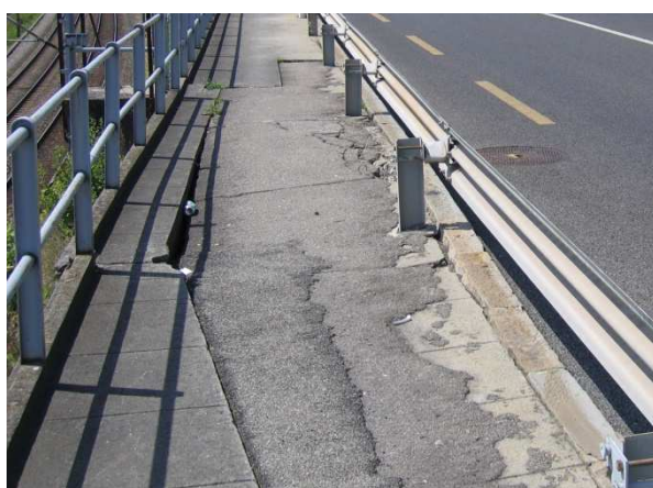
Fig. 5 : trottoir étroit et dégradé
