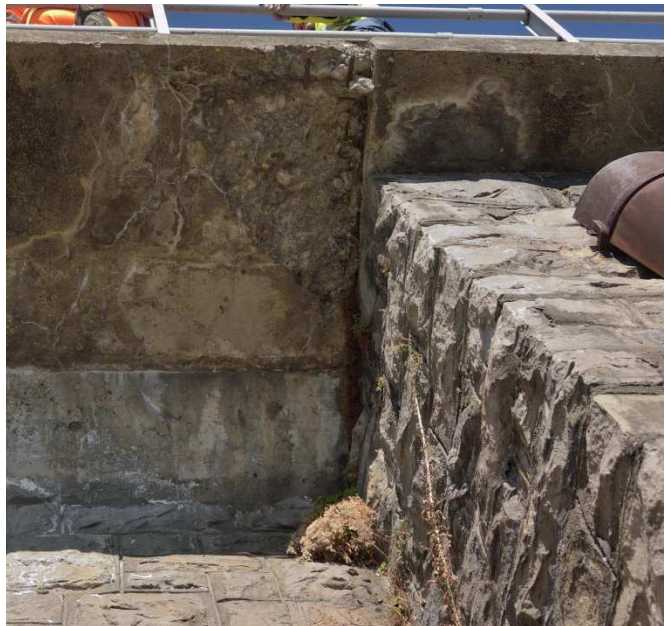
Fig. 9 et 10 : dégradations sous les estacades
